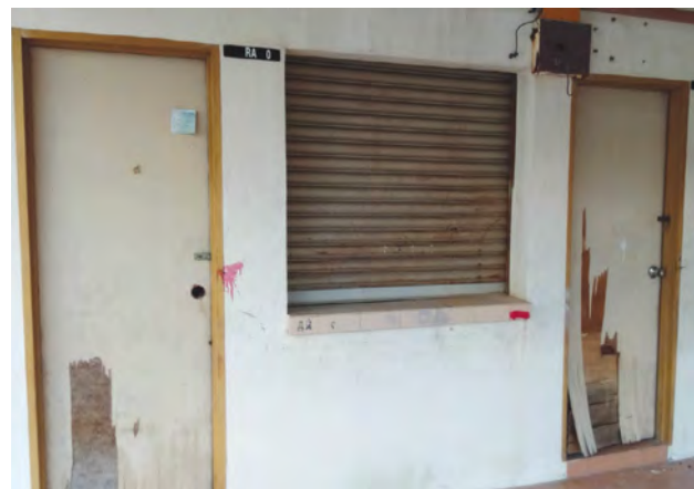
■档铺门窗都已损坏无法使用。
