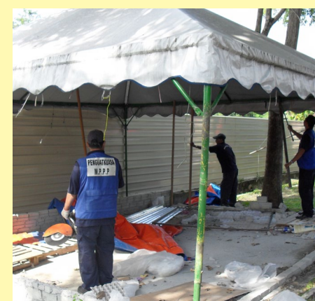
SEBUAH gerai yang beroperasi di laluan pejalan kaki dirobohkan demi kepentingan dan keselamatan awam di Bayan Baru baru-baru ini.
